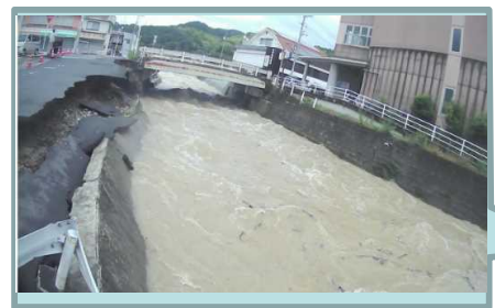
三津大川水系三津大川の河岸侵食 (広島県東広島市)
