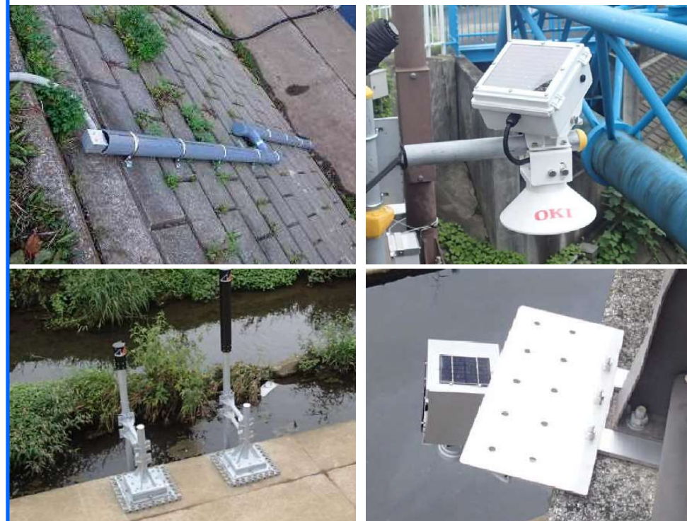
危機管理型水位計の設置事例
