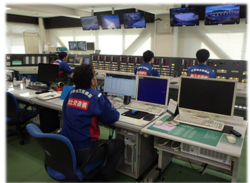
瀬田川洗堰操作室
