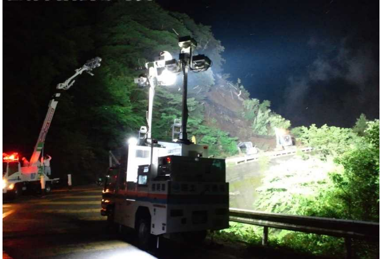
照明車稼働状況写真
