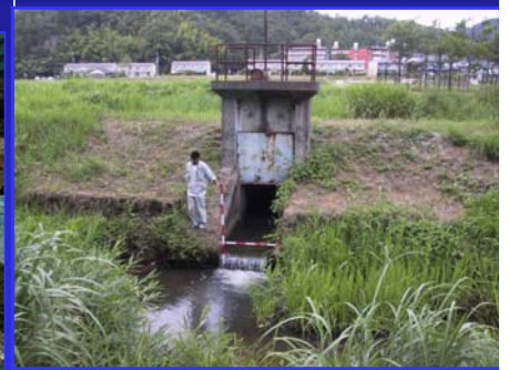
段差による分断
