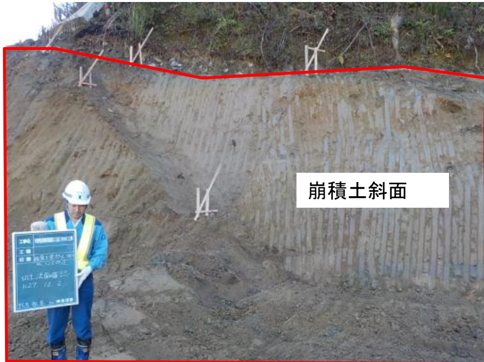
崩積土斜面部の出現状況
