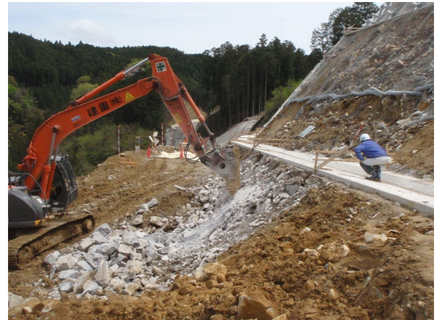
掘削法面への転石発生
