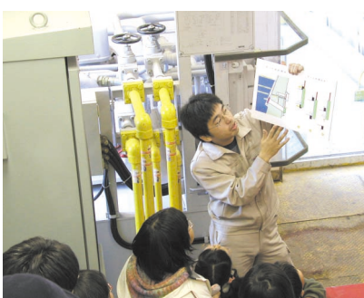
真名川ダム機械設備
