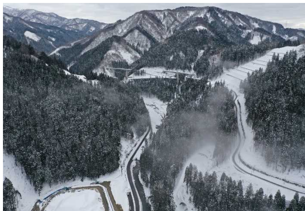
[10]足羽川ダム原石山掘削他工事 (ダムサイト下流より) R3.2.19時点
