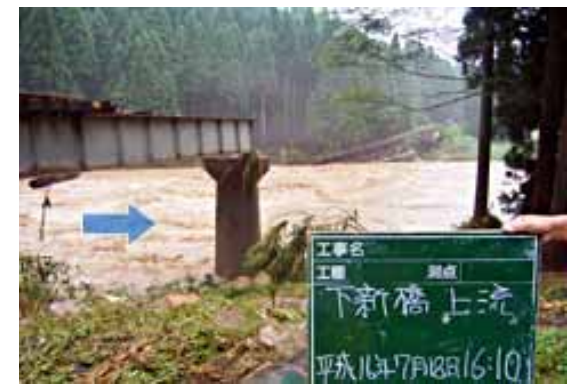
鉄道橋脚の転倒 (JR第3号橋梁・旧美山町)
