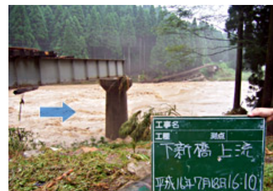
鉄道橋脚の転倒 (JR第3号橋梁・旧美山町)
