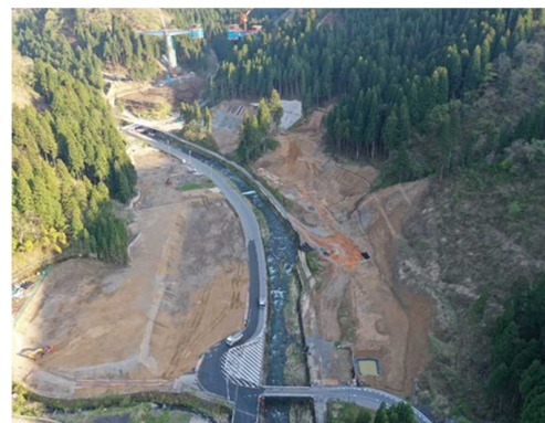
(骨材製造設備ヤード)
