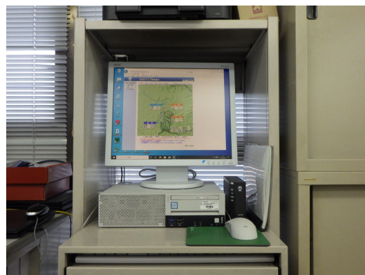
②パソコン足羽川ダム雨量・水位監視システム
