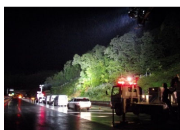
照明車 (平成29年9月 台風18号)
