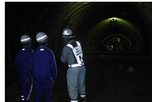
荒島第一トンネルの工事現場で トンネル掘削現場の見学
