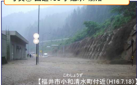
写真① 国道158号 冠水・崩落
