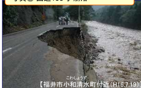
写真② 国道158号 崩落
