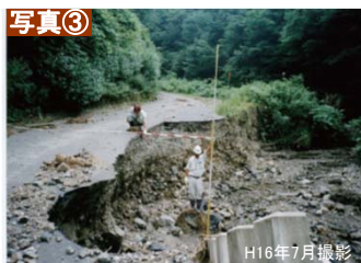
降雨による路体崩壊
