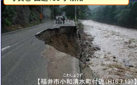
写真② 国道158号 崩落
