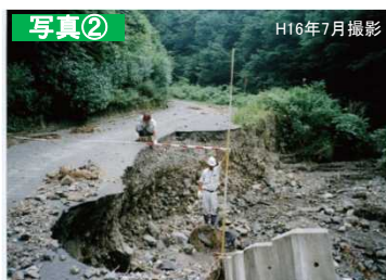
降雨による路体崩壊
